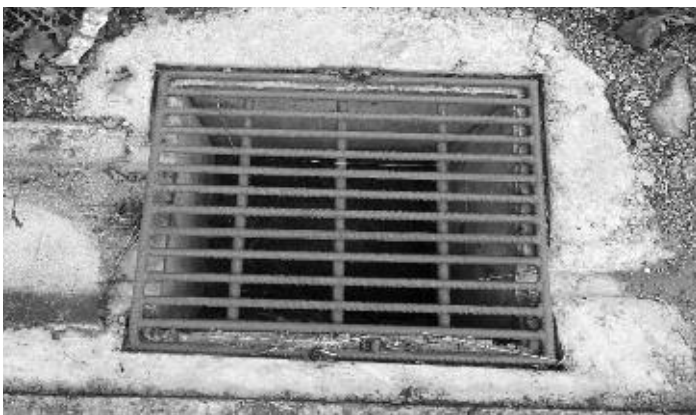
Zberná šachta na dažďovú vodu u Rucka
